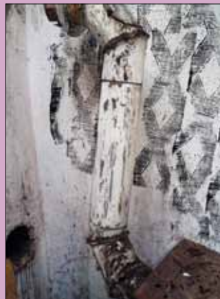
od lewej: Nieszczelny piec kaflowy ze śladami okopceń Żle podłączony do komina gazowy piecyk łazienkowy Piecyk grzewczy na paliwo stałe wadliwie podłączony do komina na str. 22: Do całkowitego spalania 1 m 3 gazu ziemnego CH 4 potrzeba około 13 m 3 powietrza
